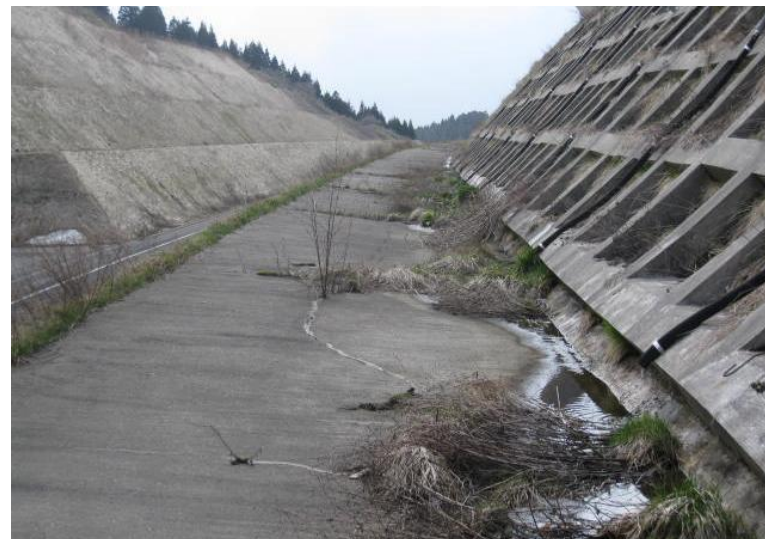
水抜きボーリングからの著しい排水
