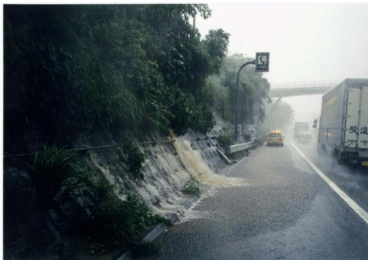
異常湧水の発生状況
