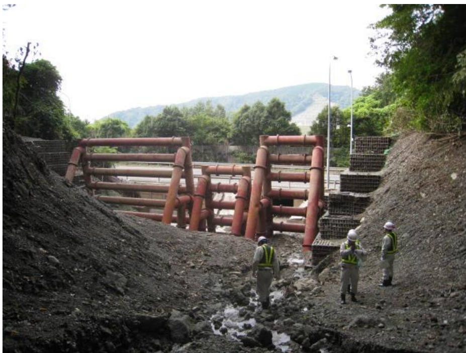
土石流対策として透過型えん堤を設置（H10.8に被災して設置）
